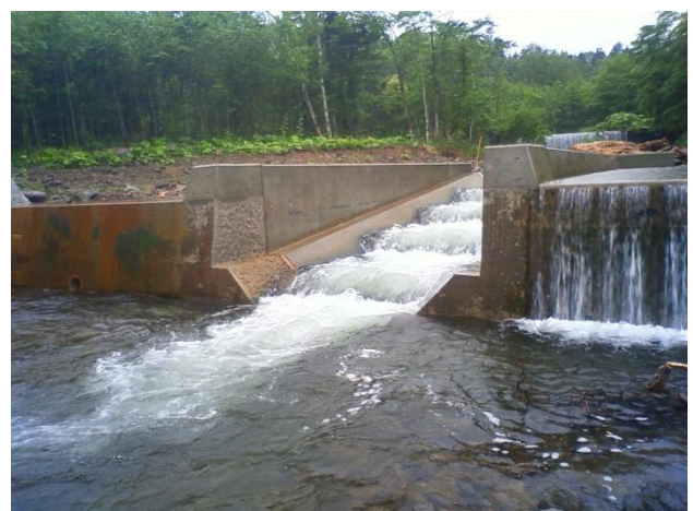
図-4 No. 2 床固工に設置された魚道。
