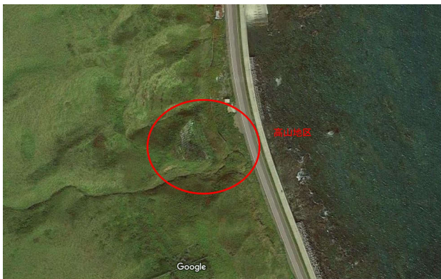
図-2 周辺の GoogleMap. 赤い破線の範囲が高山地区の災害箇所. この図では復旧対策の法枠工が見える.
